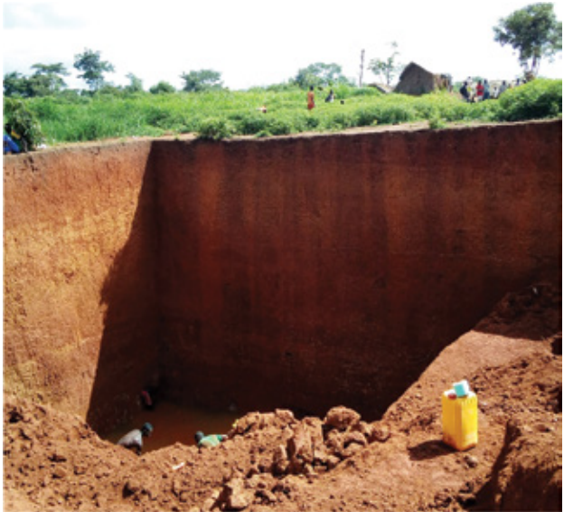
Les parois sans marches augmentent le risque d'effondrement
